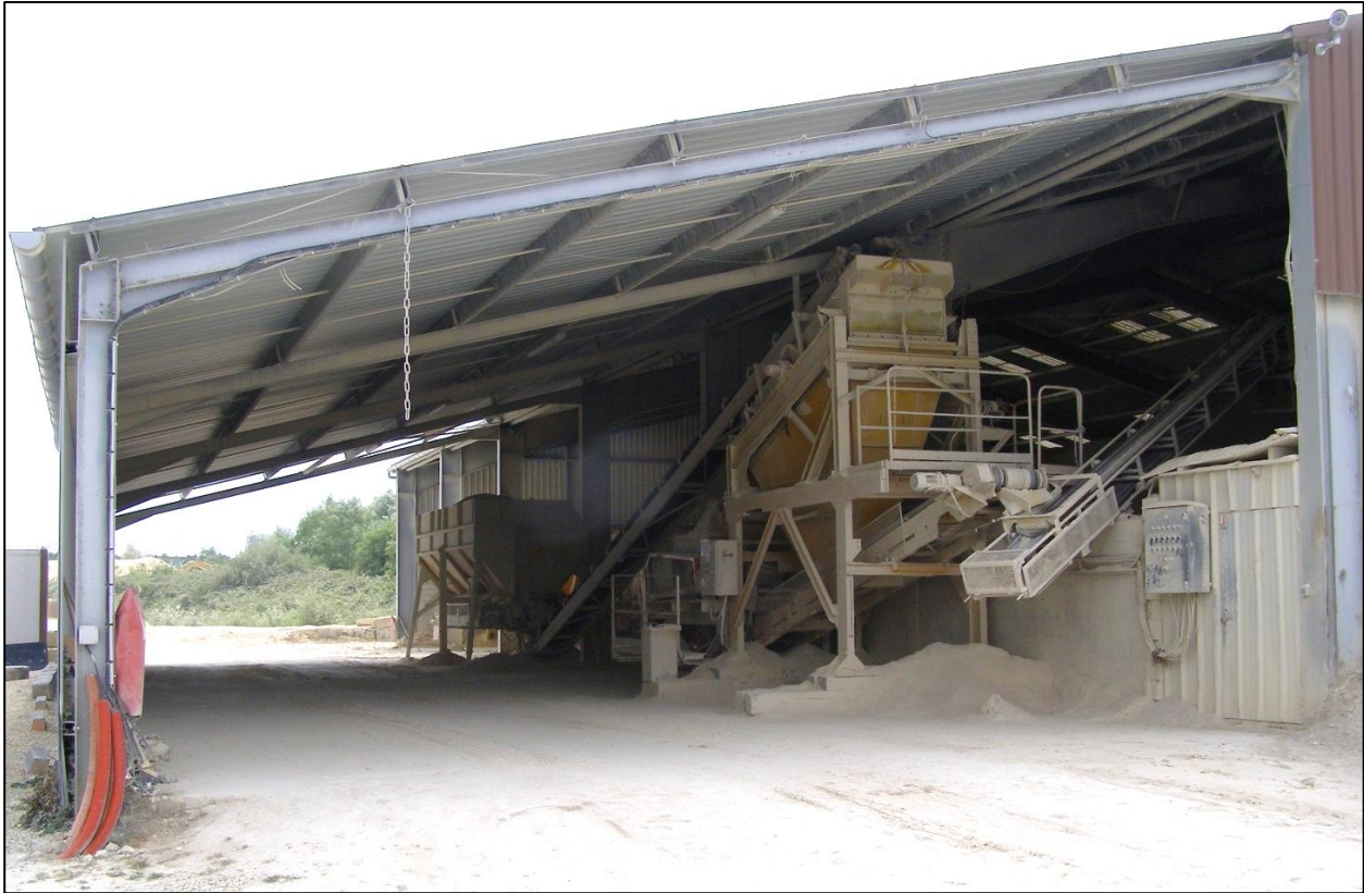
Figure 17 : Installation de traitement fixe secondaire sous le hangar (juin 2020)
